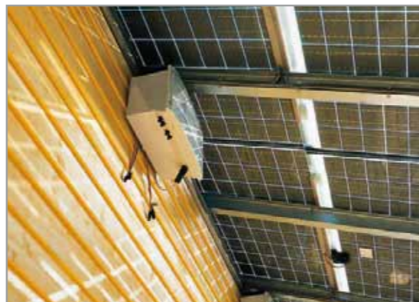
Untersicht Photovoltaikdach mit Wechselrichter
